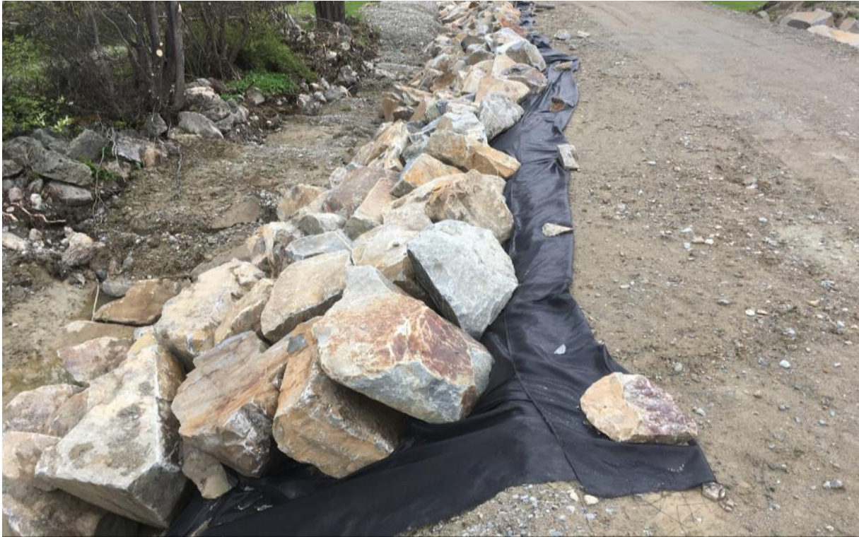
Diese Gesteinsbrocken schützen den feinkörnigen Dammkern vor der Erosion des vorbeifliessenden Wassers. Das schwarze Geotextil verhindert ein allfälliges Ausschwemmen des Feinmaterials.
