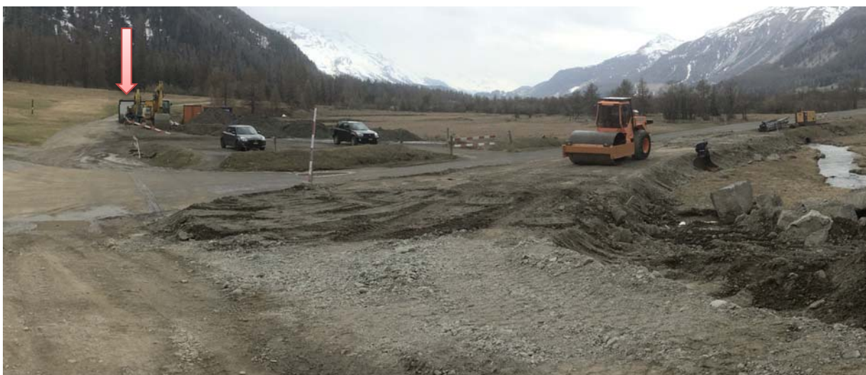
Die Vorbereitungsarbeiten für das Höherlegen von Strasse und Parkplatz haben begonnen. Die Bäume mussten weichen, ebenso das kleine Holzhüttli. Der Infocontainer fand einen neuen Standort entlang des Weges Richtung Gravatschasee (Pfeil) und ist nach wie vor geöffnet. Die Walze steht bereits auf der Aufschüttung (Foto: 25. April 2020).
