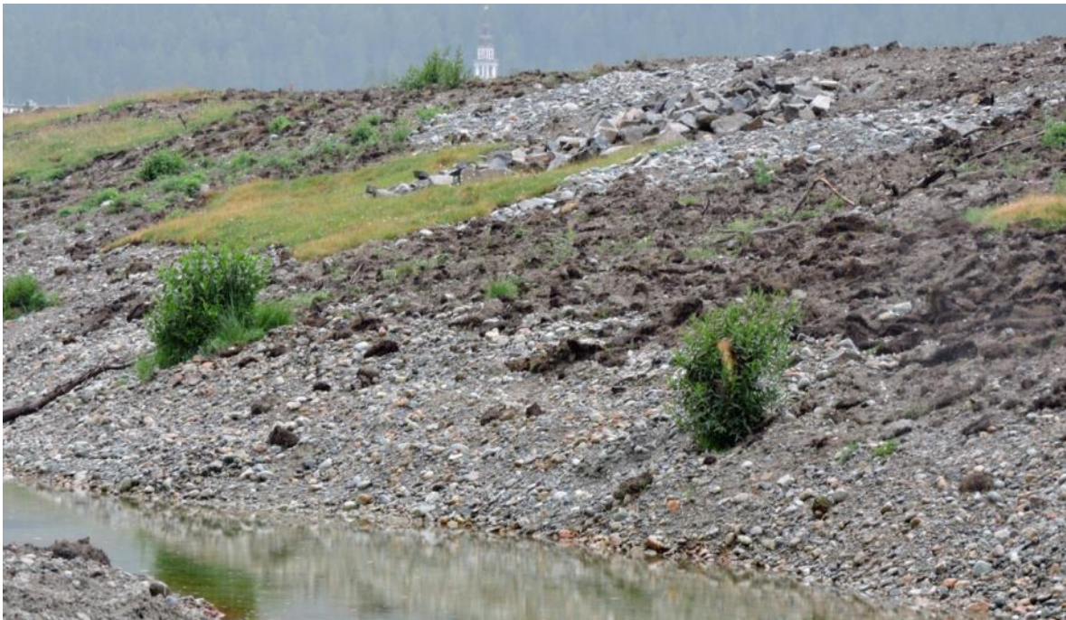
So präsentiert sich die gerade eben fertiggestellte Dammböschung Ende Juli: Die eingesetzten Wurzelstöcke der Weiden treiben schon kräftig aus, grüne Teppiche verraten die eingesetzten Rasenziegel und dazwischen bleibt auch noch genügend Erde und Geröll, damit die Natur selber aktiv werden kann.
