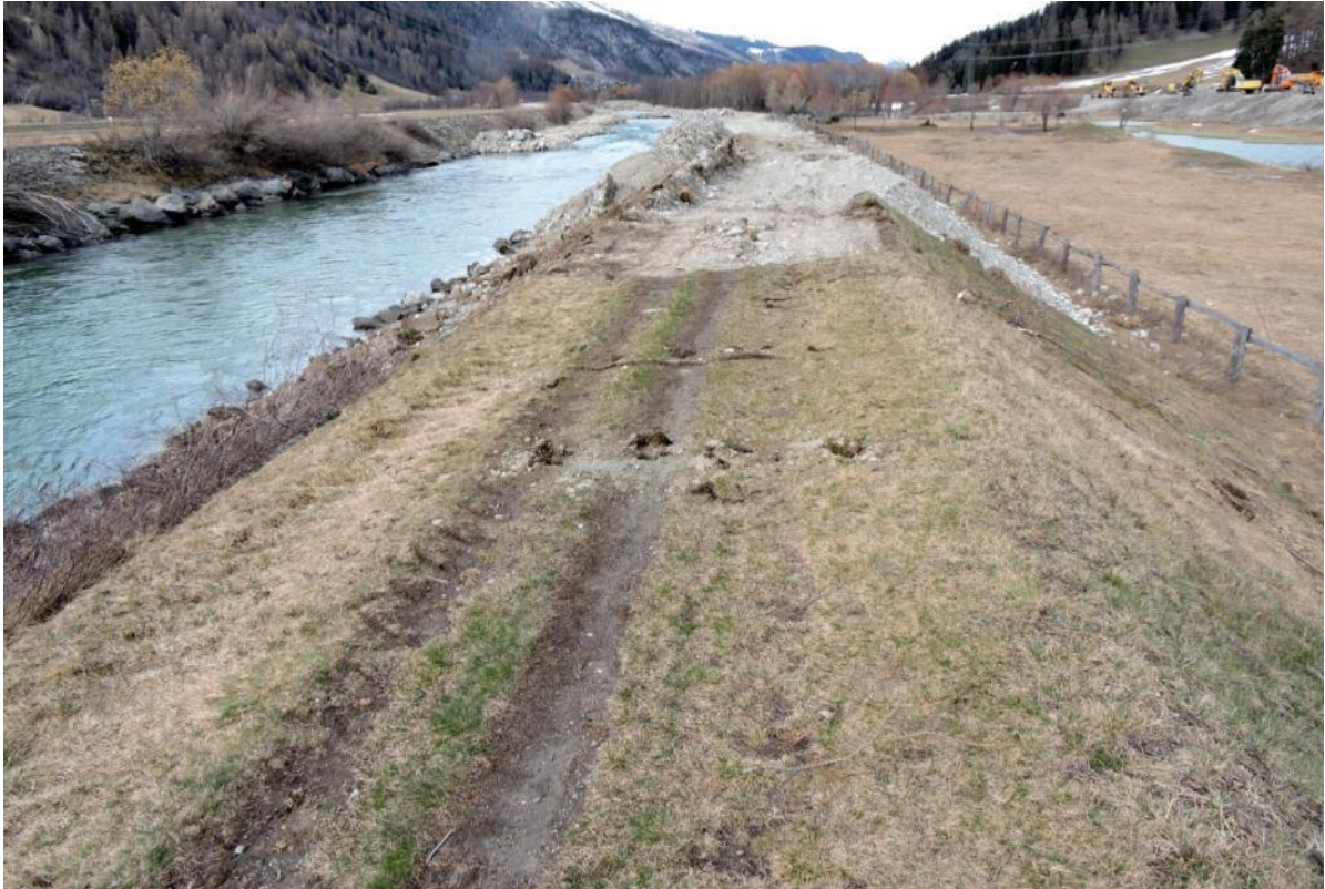
Wenn der altbekannte Dammweg plötzlich endet: Blick auf die Abbruchfront auf dem alten Damm (Foto: 4.5.19).
