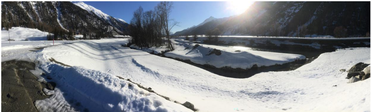
Links ist der neue Damm erkennbar, von dem aus auch das Foto aufgenommen wurde (siehe oberes Bild). In der Bildmitte sind noch die Überreste vom alten Damm erkennbar, hier werden die Abbrucharbeiten fortgesetzt (Foto: 24. März 2019).
